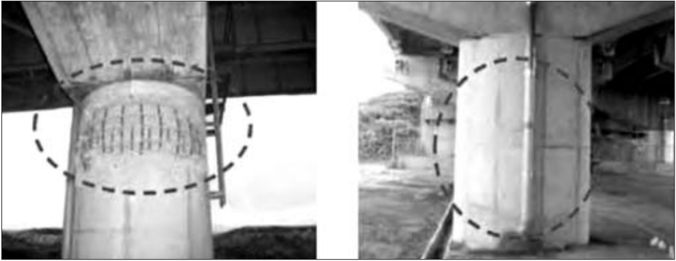
Рис. 5.30. Слева опора моста без сейсмической защиты, а справа опора усиленная железобетонным покрытием.
