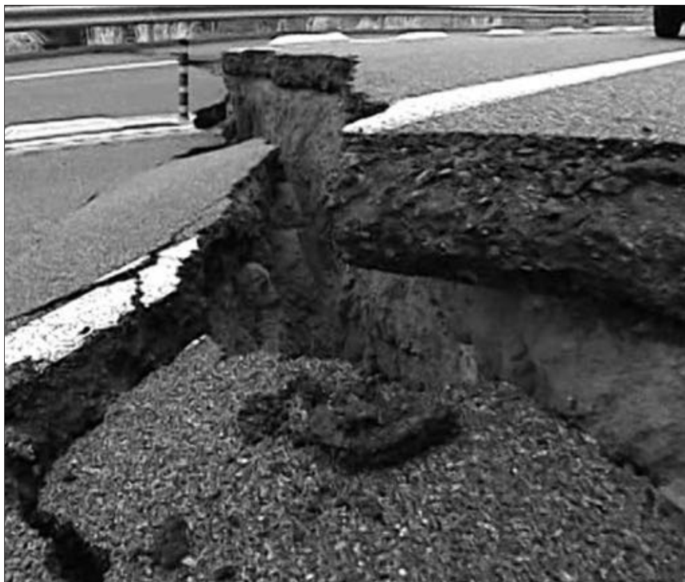
Рисунок 5.27. Мощное землетрясение с последующим гигантским цунами, произошедши 11 марта 2011 года и нанесли колоссальный ущерб автомобильным дорогам. (Национальная автомагистраль 6, хиро-но-мати, Префектура Фукусима)
